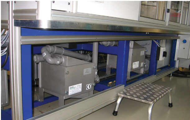
SL 7008 Box Module eingebunden in die Maschinenunterkonstruktion Filtration Grobpartikel/ Laserrauch/ Lötrauch Betrieb 24h 7 Tage
